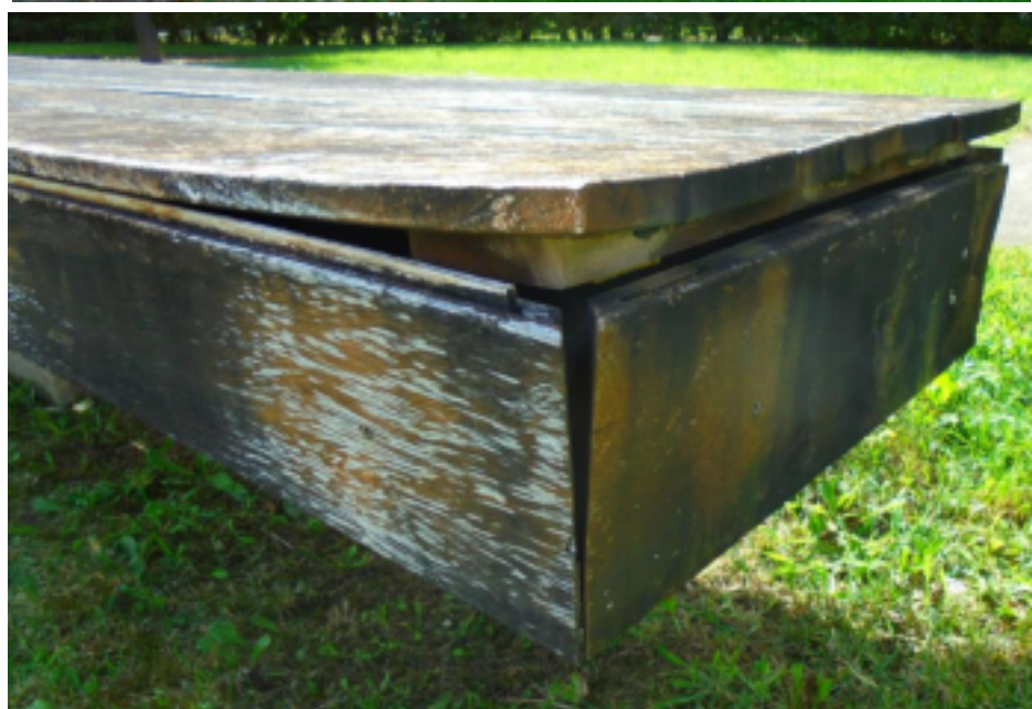
KUNNOSSAPIDON LAIMINLYÖNTI ABSENCE OF MAINTAINANCE
